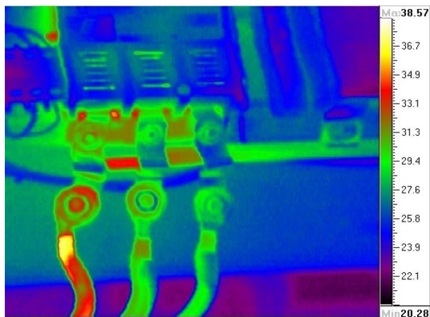
Рисунок 21. Пример термограммы контактных соединений с температурной шкалой
